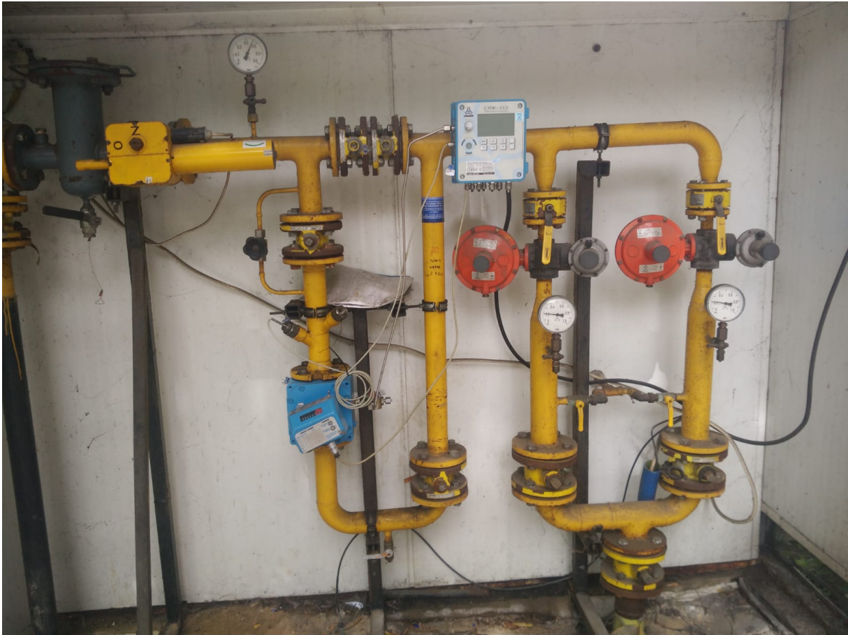
Zdj. Nr 2 – stacja redukcyjno-pomiarowa w Szp. przy ulicy Bony 1/3
