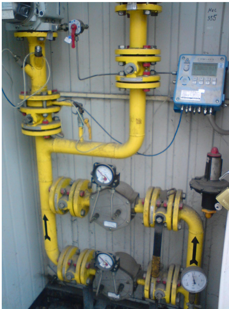
Zdj. Nr 1 – stacja redukcyjno-pomiarowa dla Pawilonu C'
