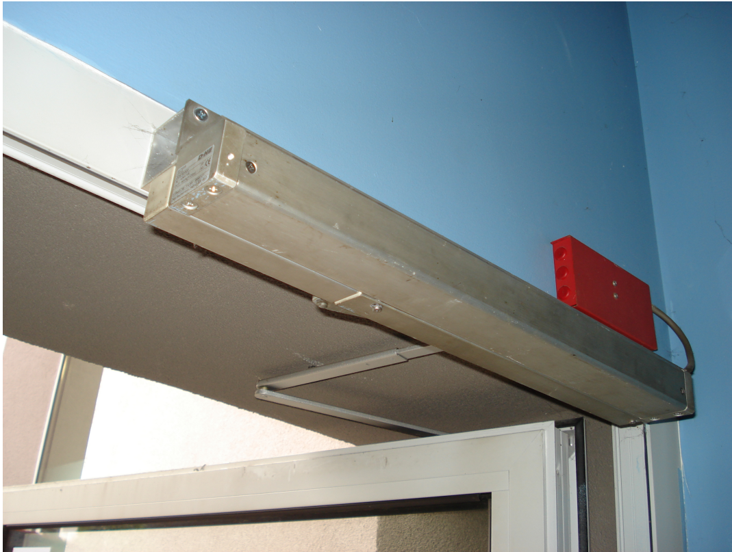
Zdjęcie Nr 2 – Siłownik D+H (wejście do Pawilonu B)
