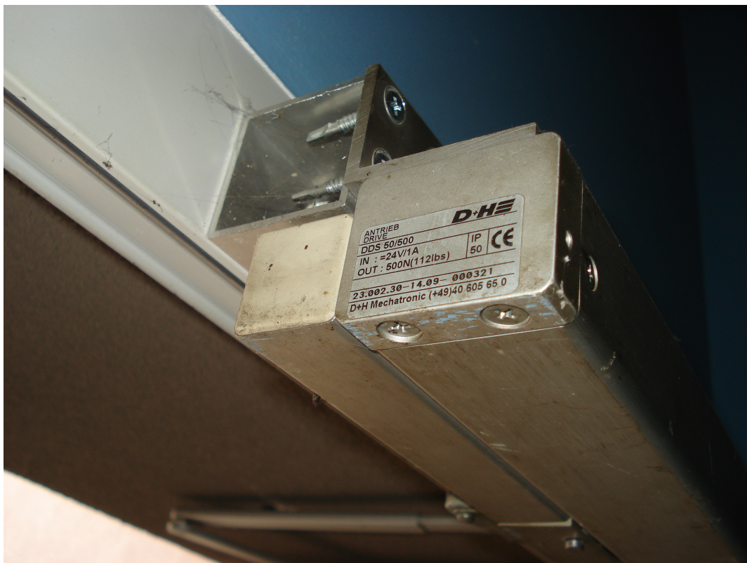
Zdjęcie Nr 1 – Siłownik D+H (wejście do Pawilonu B)
