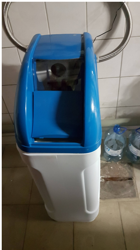
zdj. Nr 8 stacja uzdatniania wody
