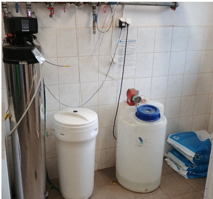
zdj. Nr 6 stacja uzdatniania wody + dozownik chemii
