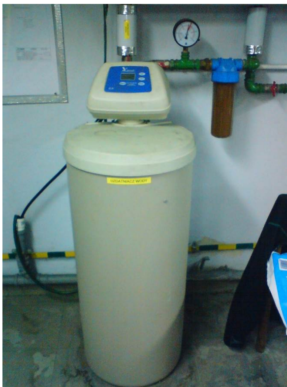
zdj. nr 4: Stacja uzdatniania wody kotłownia Nr 2 „nowa”
