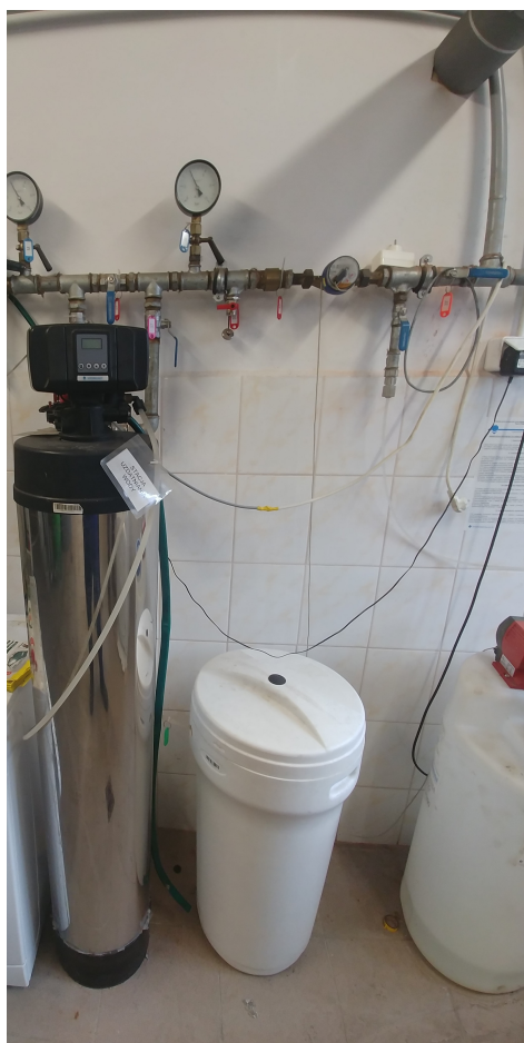
zdj. Nr 7 stacja uzdatniania wody
